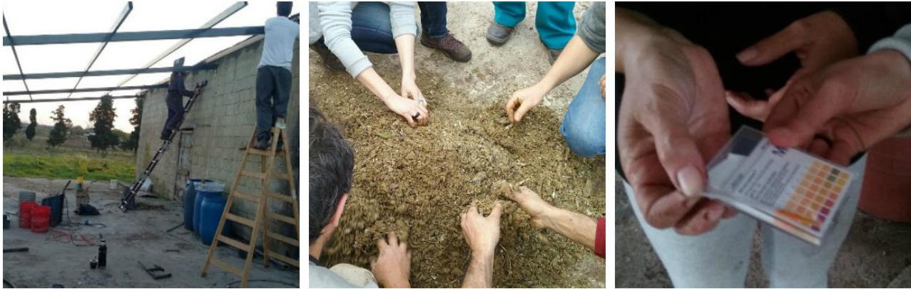
(Izquierda) construcción de galpón por parte de los productores/as, (centro) elaboración de BP en forma colectiva (derecha) medición de pH de los BP en campo con productores/as.
