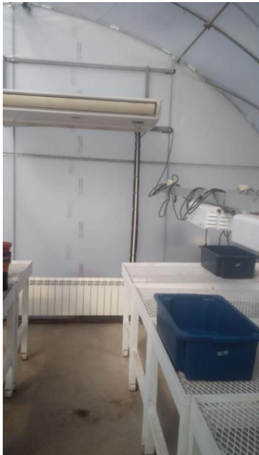
Fuente: elaboración propia, posición del aire acondicionado con respecto a la distribución del experimento:
